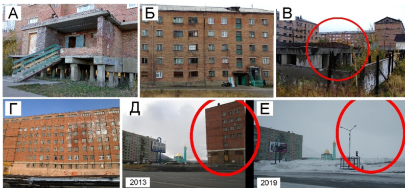
Рисунок 10. Строительство зданий и сооружений на вечной мерзлоте сопряжено со многими проблемами. Вентилируемые подполья — характерный прием строительства на вечной мерзлоте (фото А, Игарка). Воздействие процессов в вечной мерзлоте на здания и сооружения: деформация фасада жилого дома (фото Б, Игарка), остатки жилого дома, разобранного из-за опасности обрушения (фото В, Игарка), здание Института сельского хозяйства Крайнего Севера в Норильске (фото Г), полностью разобранное из-за опасности обрушения (фото Д и Е). Фото Н. Ю. Замятиной
